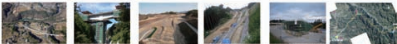
① 千代地区の工事状況 ② 20号橋の工事状況 ③ 龍江地区の工事状況 ④ 下久堅地区の工事状況 ⑤ 上久堅地区の工事状況 ⑥ 3工区(喬木地区)全景 3
